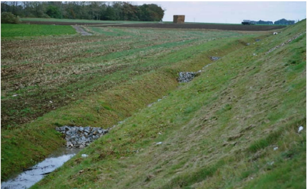
Figur 17. Exempel på dämmen i vägdike för att öka utjämningsvolymen och skapa trögare avrinning av dagvatten. Anläggning nära den tyska staden Aachen längs med motorväg E314 (Fachhochschule Münster, 2006).
